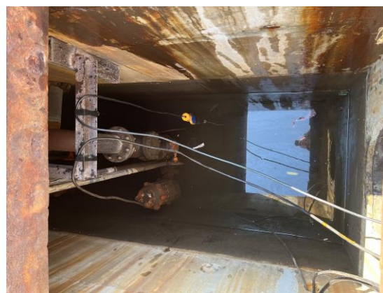
集水池及潜水泵
